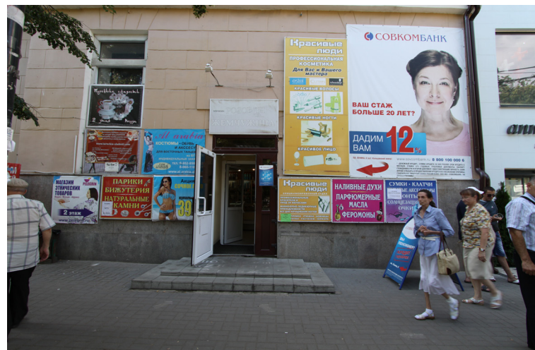
Почти все конструкции на этом доме должны быть отнесены к рекламным и демонтированы с фасада дома. (п. 3.2.1) Площадь Ленина, 8.
